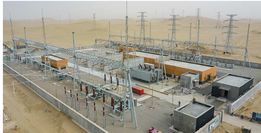
近年来,随着工业经济发展,“煤改电”等民生工程的实施,新疆和田地区用电负荷需求增大。为此,国网新疆和田供电公司积极推进电网提升工程。目前,和田市北220千伏变电站工程、策勒县220千伏变电站工程等重点工程相继进入收尾阶段,将按计划于今年年底前投入运行。图为建设中的新疆和田地区和田市北220千伏变电站(无人机照片)。
