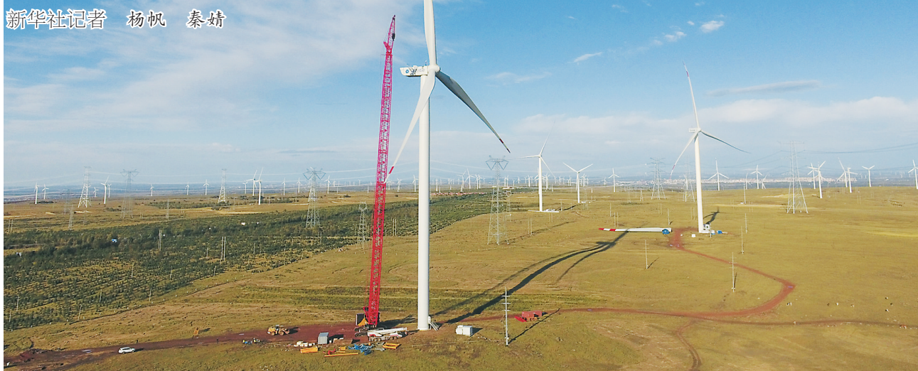
图为工人在张家口市张北县大河乡一处风电场安装风力发电机(无人机拍摄)。
