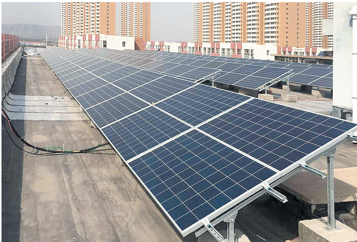
在平城区第10小学校的闲置屋顶上安装的容量为95.2千瓦的分布式光伏发电站,每年可发电19万千瓦时,在一定程度上解决了学校的办公照明、师生热水使用和景观道路照明的供电问题。本报记者 戎禹仁摄
