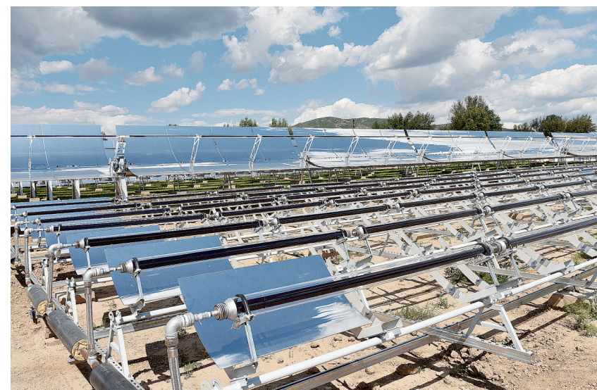
广灵县易地扶贫搬迁—斗泉乡安置点太阳能供暖项目。
