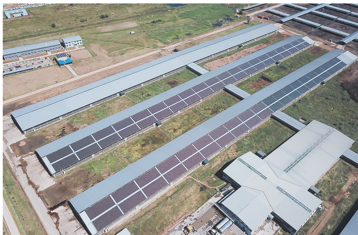
图为大同市天镇中地生态牧场有限公司牛舍顶棚800kW分布式光伏扶贫项目俯瞰。该项目收益将用于8个贫困村建档立卡贫困户生活补助和村级公益事业建设,可确保160户深度贫困户户均年增收3000元。 本报记者 张占兵摄
