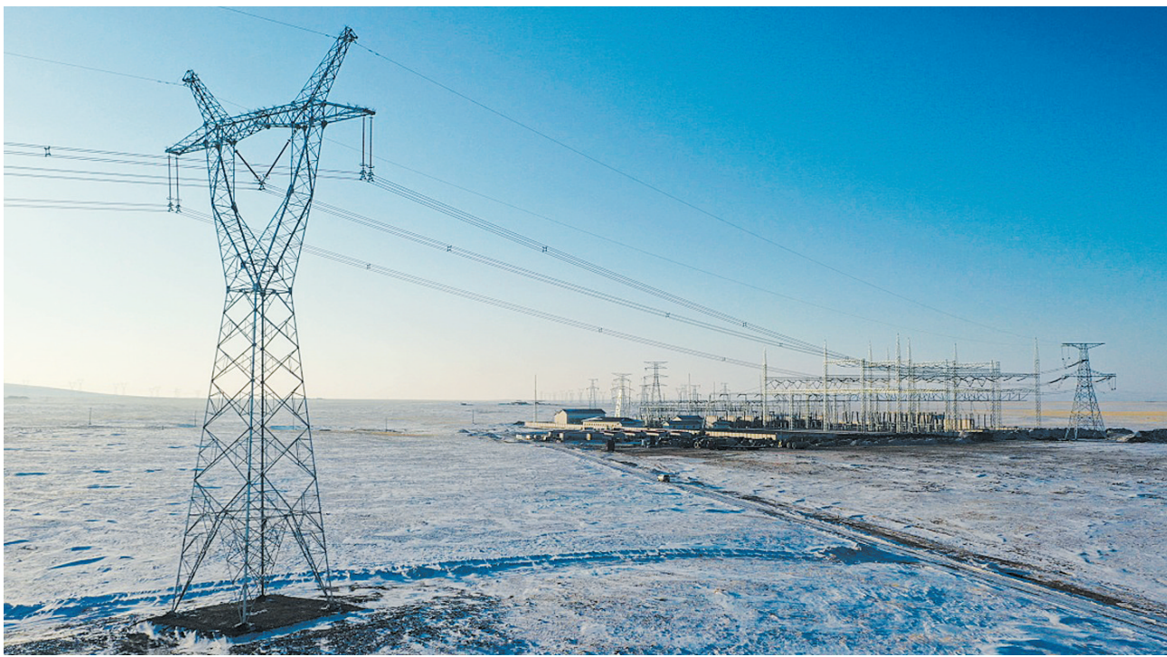
这是2020年12月21日拍摄的“五站五线”新能源汇集工程(无人机照片)。日前，位于内蒙古锡林郭勒盟的“五站五线”新能源汇集工程正式投运，将把锡林郭勒盟丰富的风电资源通过特高压线路送往北京、天津、河北、山东、江苏等地，为经济社会发展、大气污染防治和加快能源绿色低碳转型贡献力量。
