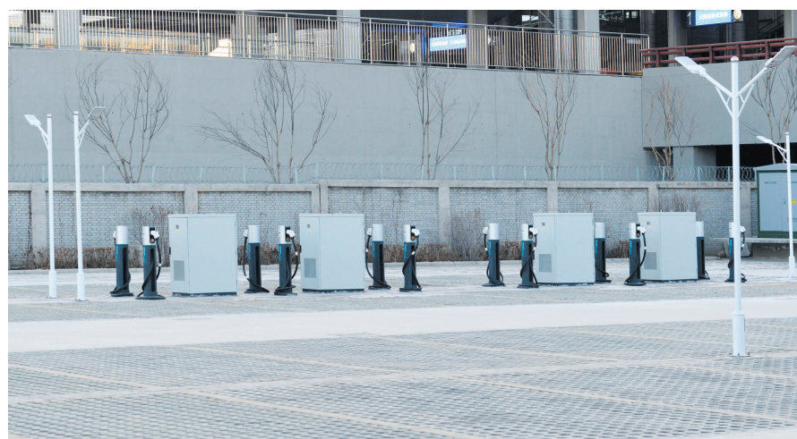
大同南站东侧一座充电站正在加紧建设,目前已安装了12台充电桩。该充电站建成投入使用后,将极大方便周边广大市民对电动汽车充电的需求。本报记者 戎禹仁摄
