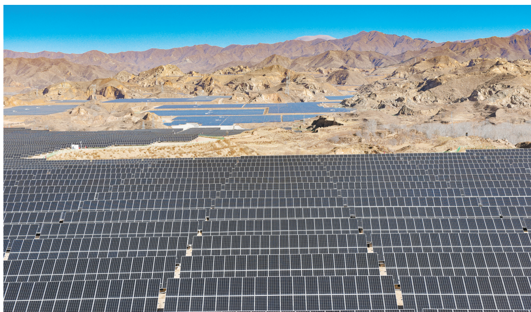
为响应国家清洁能源发展战略,促进贫困人口增收增收,山西大同煤业集团与灵丘县经济建设投资有限公司合作建设的30兆瓦集中式光伏扶贫发电项目每年可有效带动灵丘当地1000户贫困人口实现持续稳定增收,实现了生态修复、环境治理、产业扶贫与新能源建设的有机结合。
