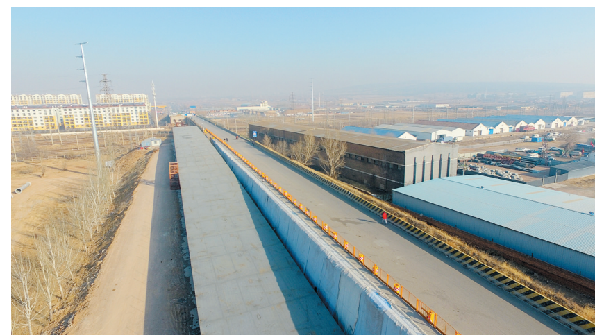
记者1月20日从燕庄桥改建工程项目部了解到,目前燕庄桥30节钢箱组梁焊接已完工。燕庄桥全称为燕庄公铁立交桥,全长182米,北接G109国道,南接文兴路,与京包线、大准线相邻,11条客运、货运铁路干线从其下穿过,是御东片区乃至我市的重要交通枢纽。由于年久失修等多种原因,大同公路分局2017年开始对燕庄桥进行改建,经过4年多的施工,改建工程已接近尾声。 本报记者 于宏摄
