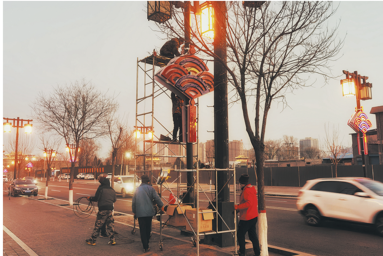
为营造浓厚的节日氛围,我市在大同古城各主要道路两边安装彩灯,目前已近尾声。图为昨日,工作人员在和阳街安装彩灯。 本报记者 张占兵摄
