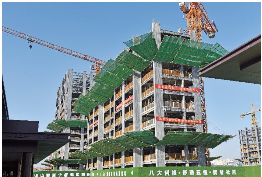
大同国际能源革命科技创新园D区的瑞湖·云山府是我省首个“装配式+被动式”超低能耗绿色建筑示范小区,当前该小区西区13栋单体建筑主体结构已基本完成。本报记者 李冬宾摄
