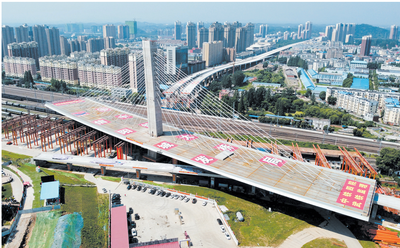
这是6月22日拍摄的河南信阳跨京广铁路斜拉桥转体施工现场(无人机照片)。当日,由中铁大桥局承建的河南省信阳市跨京广铁路斜拉桥成功转体。转体主梁总长291米,总重量达1.96万吨。 新华社记者 朱祥摄
