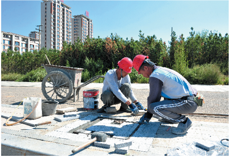
图为御东市政综合所工作人员对人行便道破损处进行修复。 本报记者 于宏撰
