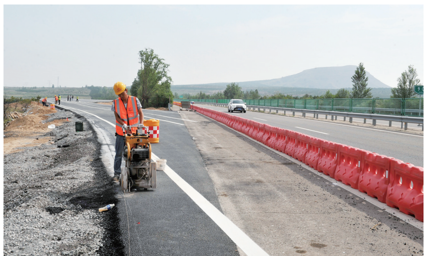
7月13日,记者在大同经开区纬一路穿天黎高速施工现场看到,保通便道的沥青已铺设完成,工人正在清理切割后多余的沥青。纬一路建设工程是联系市区与云州区火山群公园之间的一条重要主干道,全长11公里,建成后,对云州区产业布局、旅游资源的开发将起到极大促进作用。目前,下穿天黎高速段以西的道路正在施划交通标识,下穿天黎高速以东1.5公里道路完成了底层沥青的铺设。本报记者 于宏摄
