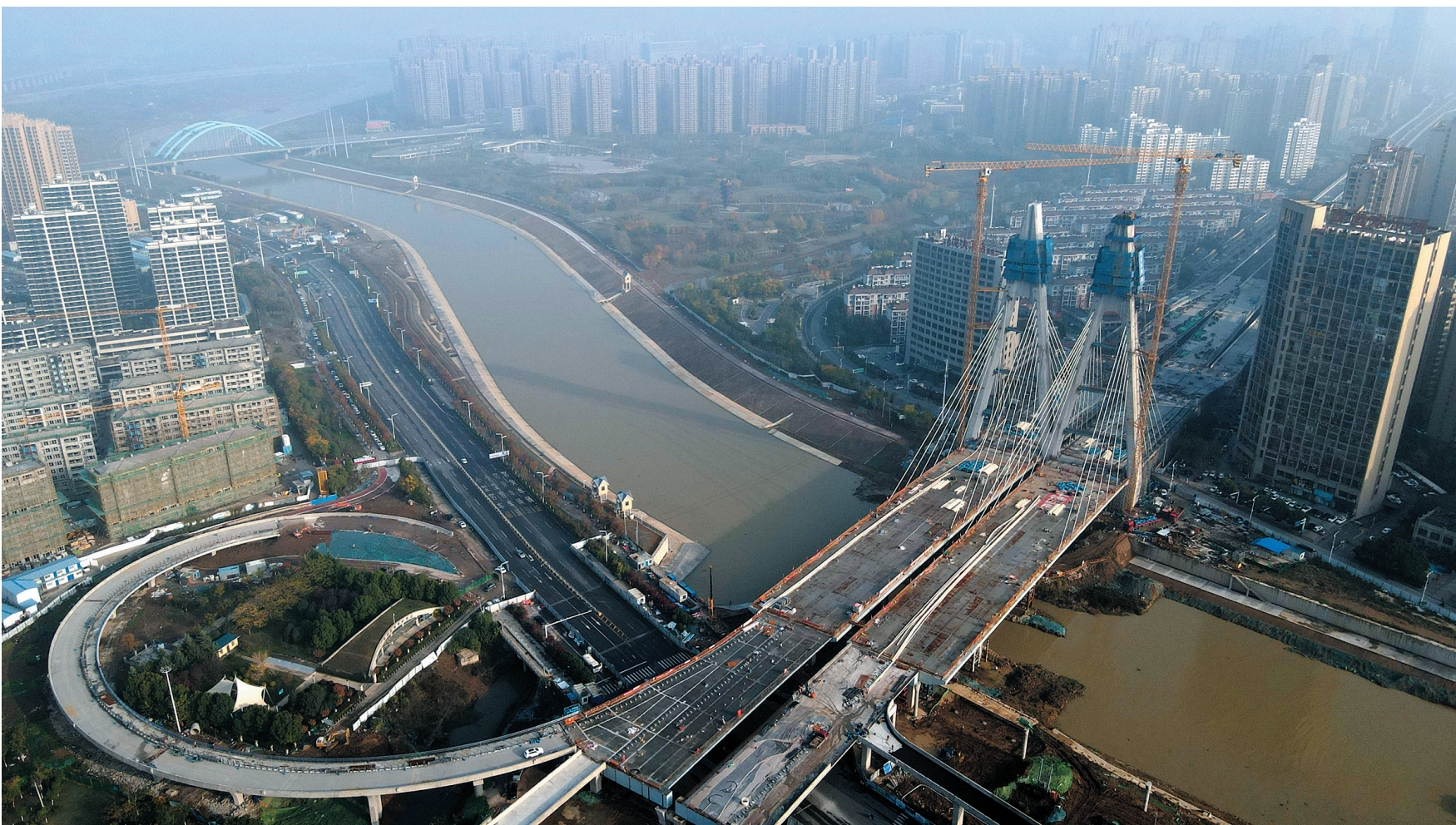
这是正在进行主塔封顶施工的引江济淮金寨南路桥(11月24日摄,无人机照片)。 当日,由中铁四局承建的引江济淮工程江淮沟通段金寨南路桥主塔封顶。该桥跨越引江济淮工程航道,全长635米,设计为独塔斜拉桥,此次封顶的主塔塔高112米。引江济淮工程沟通长江、淮河两大水系,是我国跨流域、跨省重大战略性水资源配置和综合利用工程。 新华社记者 刘军喜 摄
