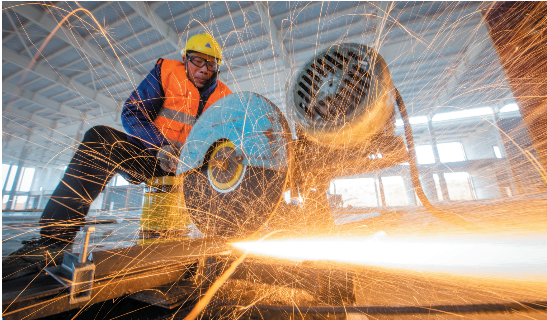
2月5日,在中建三局三公司承建的湖北省孝感楚能新能源项目工地,工人在切割角钢。当日是元宵节,各行各业的许多劳动者们仍坚守在岗位上。不少地方还开展丰富多彩的慰问、联欢等活动,共度佳节。新华社记者 伍志尊摄
