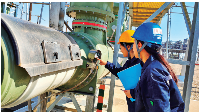
连日来,国网冀北超高压公司大同运维分部组织变电专业运维人员对设备进行联合特巡,确保全国两会期间“西电东送”大通道和首都北京供电安全。本报记者 于宏 通讯员 黄廷保摄
