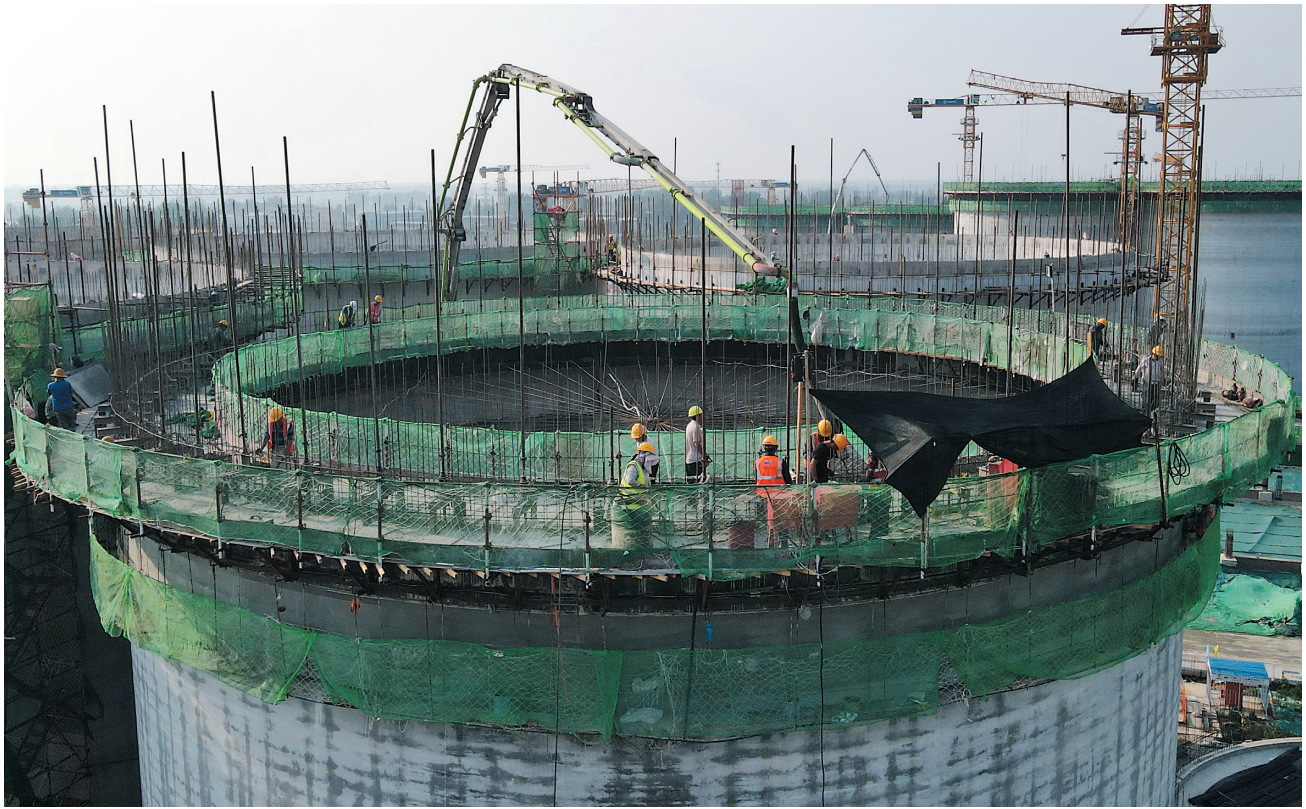
7月8日,工人在粮食安全应急储备及食品深加工全链化综合生产基地项目建筑工地施工(无人机照片)。近日,河北省唐山市粮食集团和丰润区城乡粮食仓储有限公司联合投资,在丰润区丰登镇大任庄村附近建设的粮食安全应急储备及食品深加工全链化综合生产基地项目,一期工程建设正在按照节点要求稳步推进。据介绍,该项目分三期建设。项目全部建成投产后,将形成以粮食储备为主链,粮食收购、粮油加工、食品加工和销售于一体的综合性“粮食小镇”。 新华社记者 杨世尧摄
