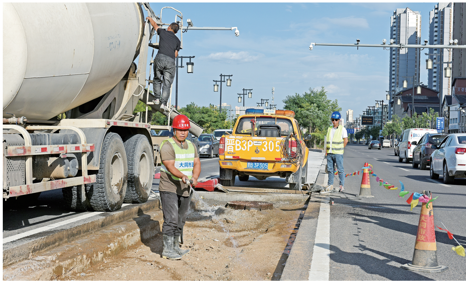
为提升城市品位、缓解城市拥堵、保障道路通行安全规范有序,连日来,市公安局交警大队对车流量大、拥堵严重的魏都大道北都路口、御河西路向阳街口、永泰南路向阳街口、迎宾街振华街口等16个岗区实施时空一体化精细改造,通过移除绿化带拓展车道、设置行人等待区、偏移中心护栏等方式,充分利用路口路段的时间与空间资源,提升交通通行能力。本报记者 于宏摄
