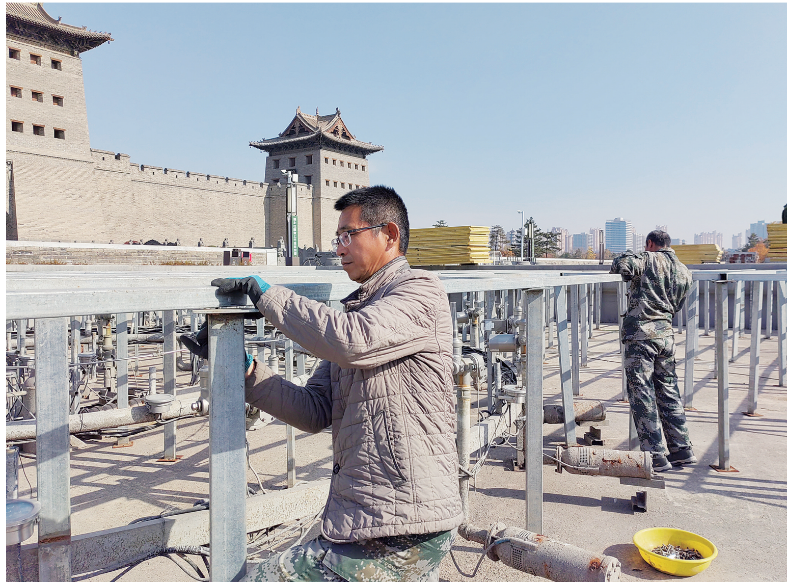
10月31日上午,工作人员在喷泉池内搭建钢质龙骨架,为永泰门广场音乐喷泉设备越冬做防护措施。据介绍,永泰门广场需要维护保养的两个喷泉池施工面积近3000平方米,预计用15至20天时间完成音乐喷泉设施越冬维护施工作业。
