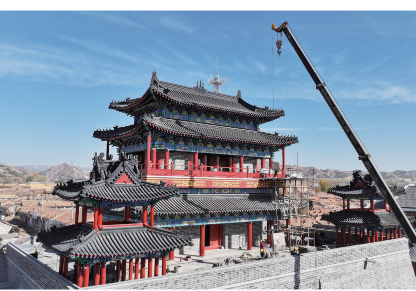
11月1日，工人在河北省张家口市万全右卫城长城国家文化公园文旅融合区项目建设工地施工（无人机照片）。据介绍，该项目是纳入《长城国家文化公园建设保护规划》的重点项目，于2021年启动，占地200亩，建筑设计均采用砖木结构，空间布局沿袭原有的街巷肌理，局部点缀保留近现代建筑，以展现右卫城的历史变迁。新华社记者 杨世尧摄
