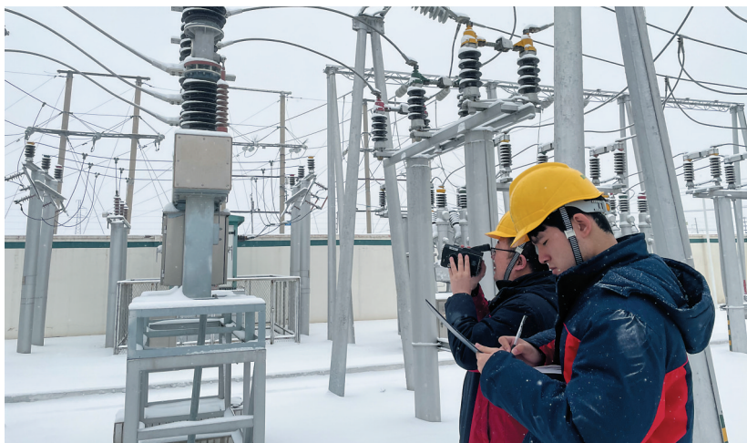
云州区供电公司组织输电运维人员开展雪天线路、变电站设备特巡工作。本报记者 于宏 通讯员 王文正摄
