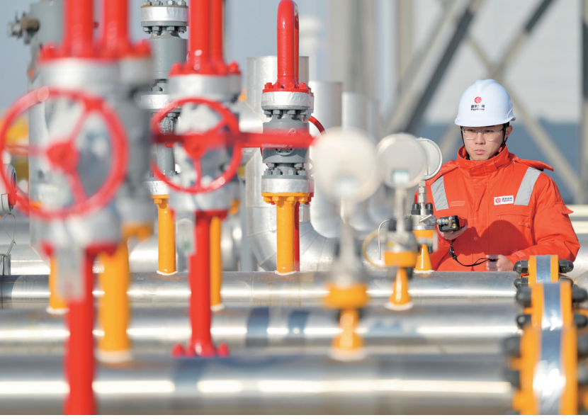
12月29日,工人在国家管网唐山联络压气站内工作。今年入冬以来,位于河北省唐山市丰润区的国家管网唐山联络压气站的工作人员,不断加大天然气管网和机器设备的巡检力度,排查隐患,确保供气安全。
