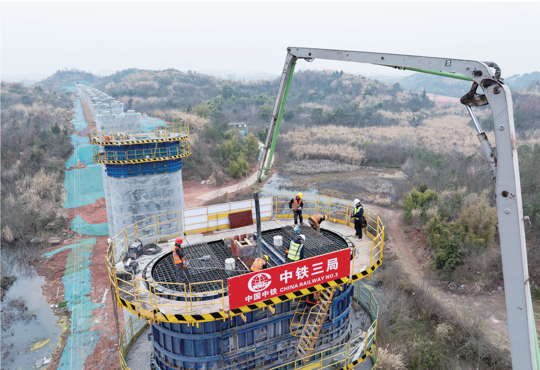
3月4日，中铁三局的施工人员在成渝中线高铁土红湾特大桥建设现场作业(无人机照片)。当日，由中铁三局承建的成渝中线高铁土红湾特大桥下部主体工程全部完工，全路段建设有序推进。成渝中线高铁是我国“八纵八横”高铁网沿江通道的重要组成部分，正线全长292公里，设计时速350公里。
