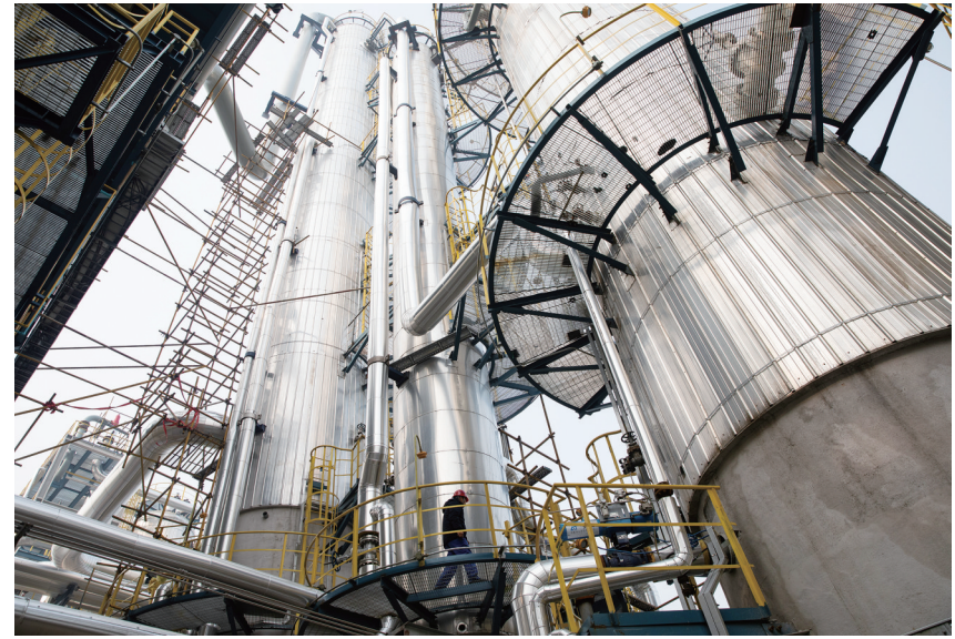
2023年12月28日，在淮北矿业集团碳素科技有限公司，工作人员在调试60万吨/年乙醇生产装置设备。新华社记者 金立旺摄
