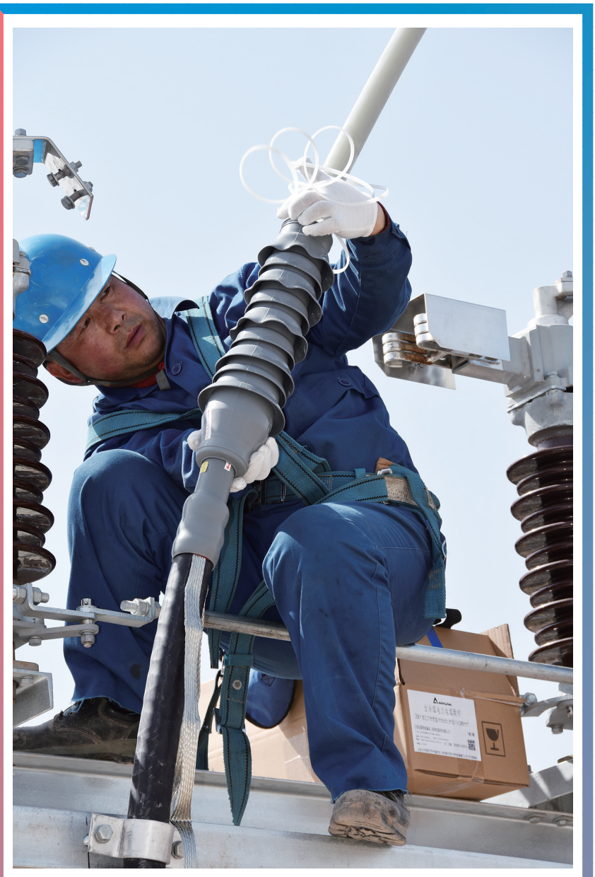
由国网大同供电公司项目管理中心负责施工的集(宁)大(同)原(平)高铁主要配套工程——大同新荣得胜220千伏变电站建设进展顺利，预计5月建成投运。该站投运后将通过孤山牵引站为在年内通车的集大原高铁提供强大的电力保障，同时将缓解马军营、北部两座220千伏变电站的供电压力。 图为4月22日，施工人员在得胜220千伏变电站进行电缆头制作。 本报记者 于宏 通讯员 魏旭摄
