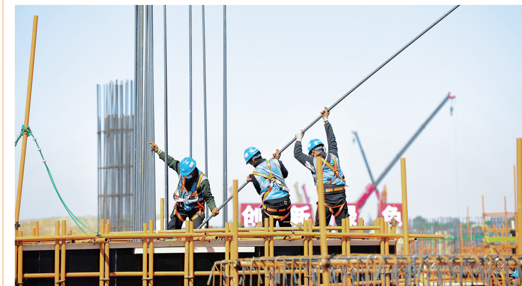
“五一”假期，国家能源集团与山西省政府重要战略合作项目——国电电力大同湖东电厂2×100万千瓦“上大压小”项目施工现场塔吊旋转、车辆穿梭，千余名一线职工在各自的岗位上争分夺秒加紧施工，全力确保施工进度。本报记者 张占兵摄
