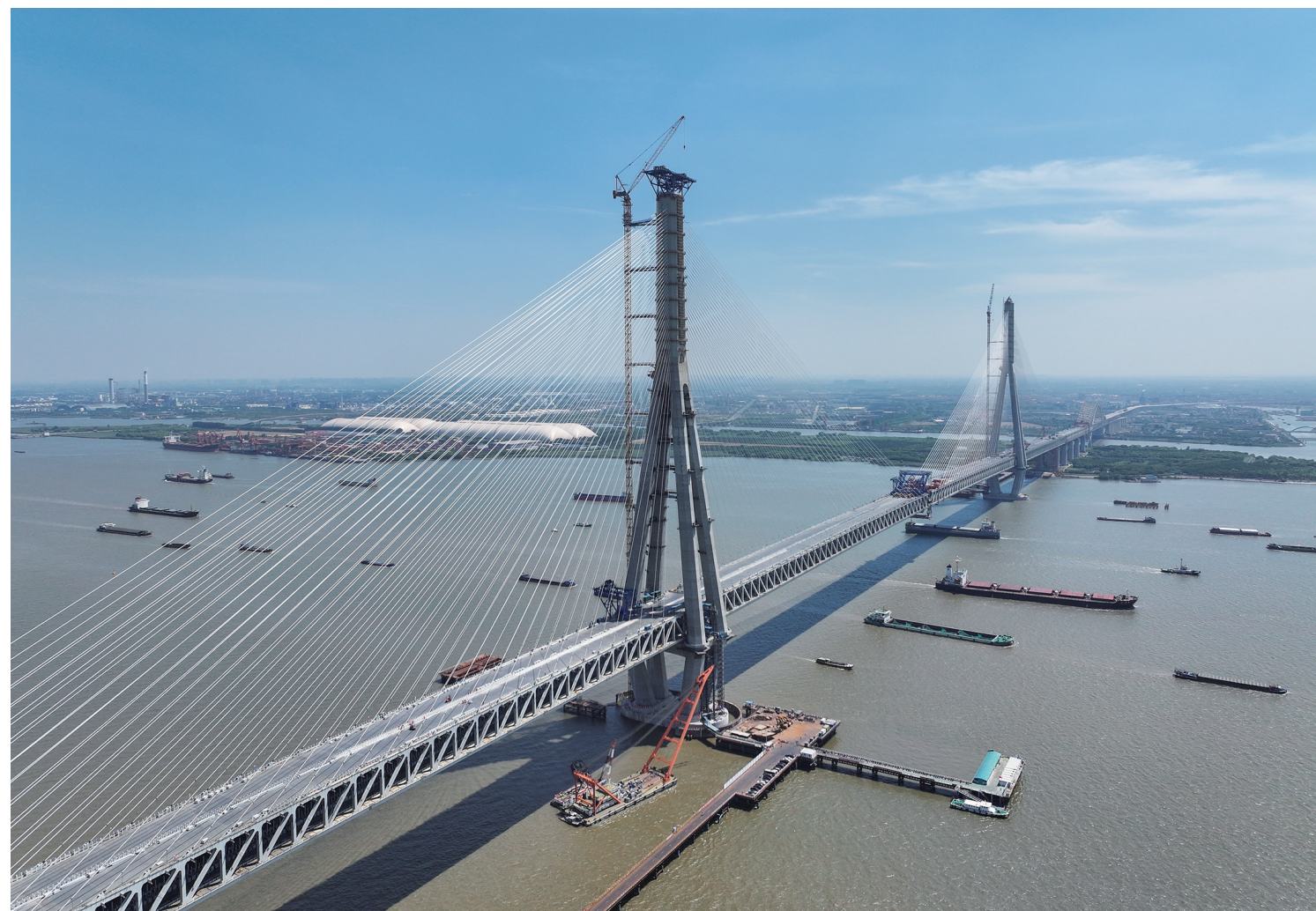
5月29日拍摄的常泰长江大桥主航道桥合龙段钢桁梁吊装现场(无人机照片)。当日，常泰长江大桥主航道桥最后一节钢桁梁——合龙段钢桁梁顺利吊装到位，拉开主桥合龙的序幕，预计6月上旬完成合龙，实现全桥贯通。
