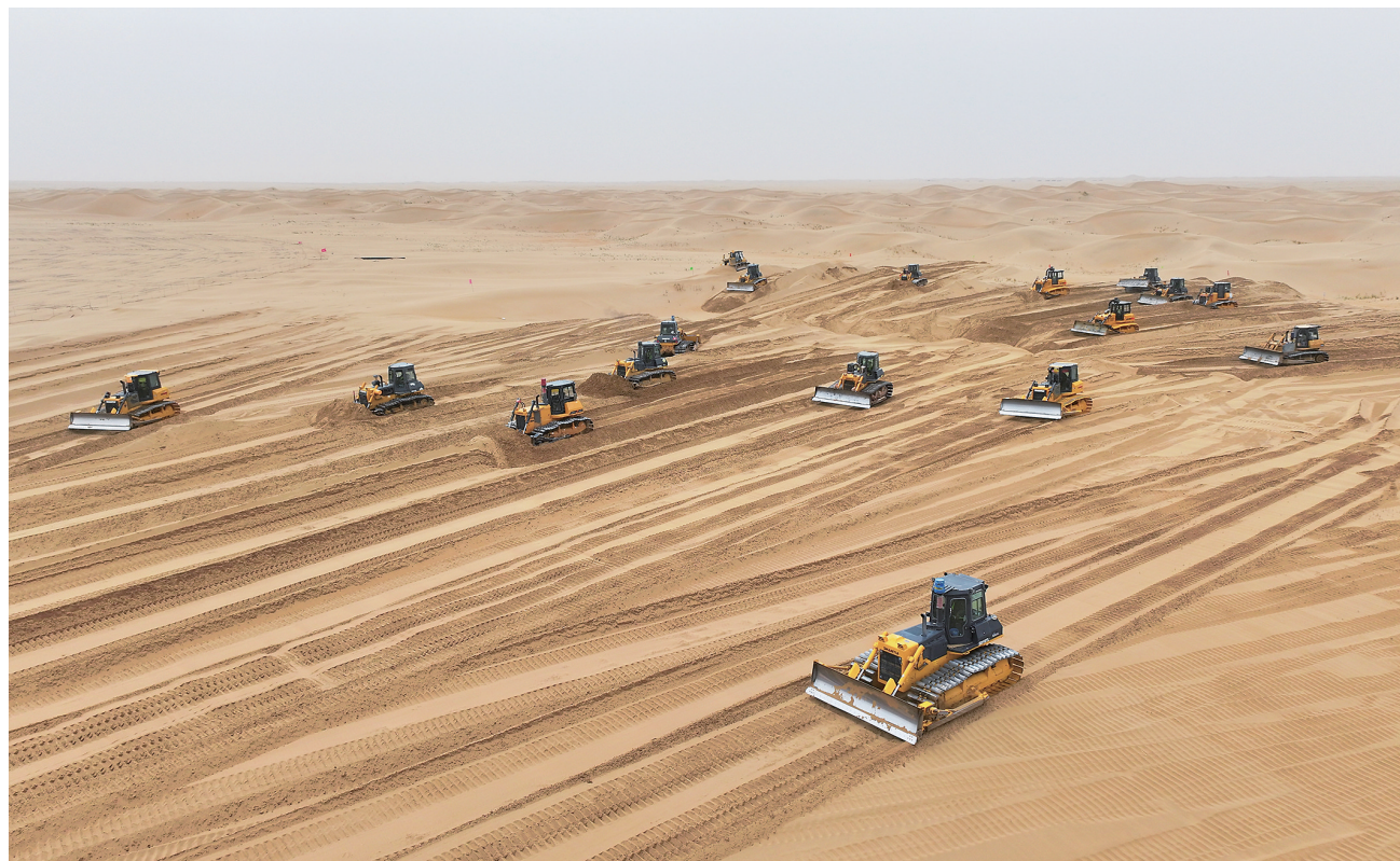
5月29日，在杭锦旗朔方新能源大基地建设现场，工程机械在施工（无人机照片）。
