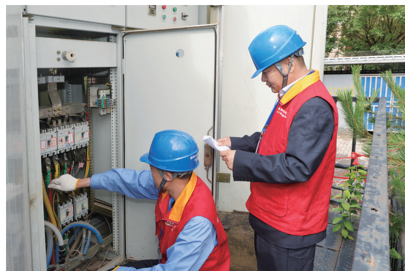
6月7日，一年一度的高考拉开帷幕。国网大同供电公司平城区供电公司全力做好高考保电工作，为广大学子安心应考提供可靠保障。图为在大同一中考点，工作人员正在检查变电设备。 本报记者 戎禹仁 摄
