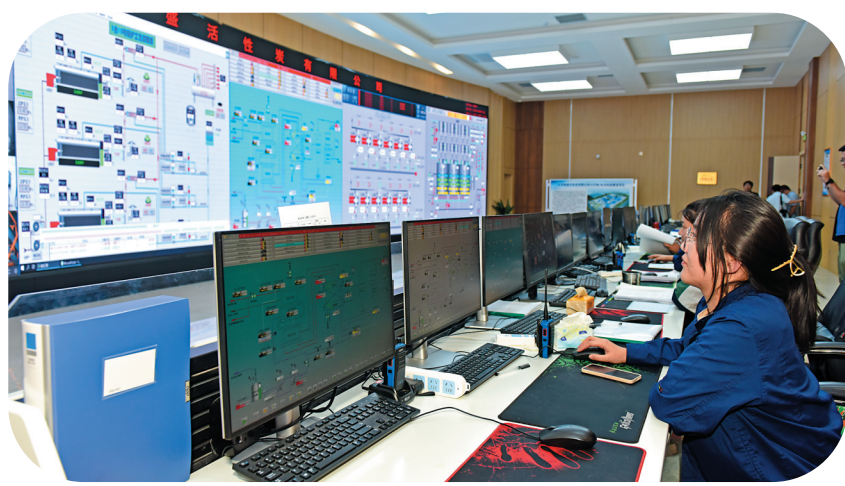
工作人员在智能化控制中心对全公司生产数据进行管控。 本报记者 于宏振
