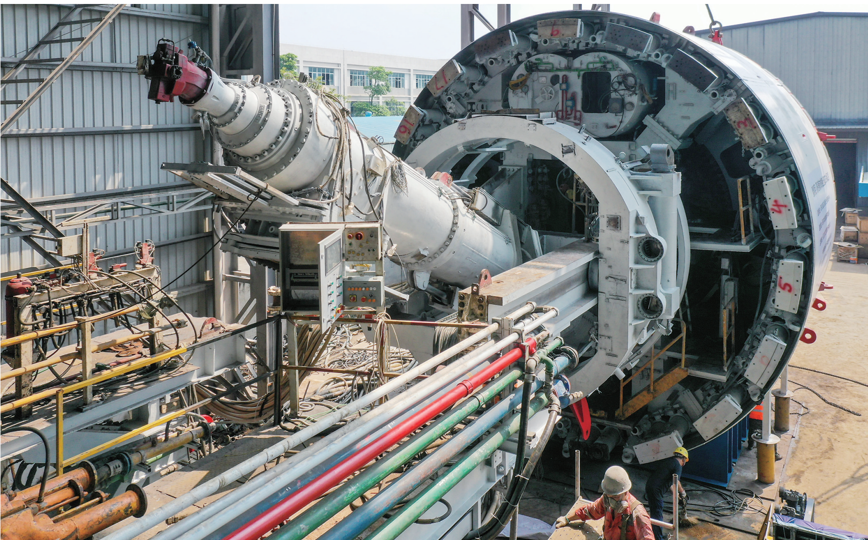
8月27日，施工人员在整备一台经过再制造的大直径盾构机的管径设备。这台2010年出厂的盾构机已到报废年限，经过设备再制造，性能还得到进一步提升。用于隧道掘进的盾构机凭借“铁齿钢牙”可以“咬碎”坚硬岩石，但相应损耗也大，设备需要经常维保和换装。中国铁建华盾盾构基地由中铁十八局组建运营，是一家专门从事盾构全产业链服务的“4S”店。近三年以来，已为大湾区提供近60套盾构设备的维保、再制造、新机组装、检测调测服务及一系列盾构相关产品。经设备再制造的回老部件可实现循环利用，并减少有害气体的排放。新华社记者 刘大伟摄
