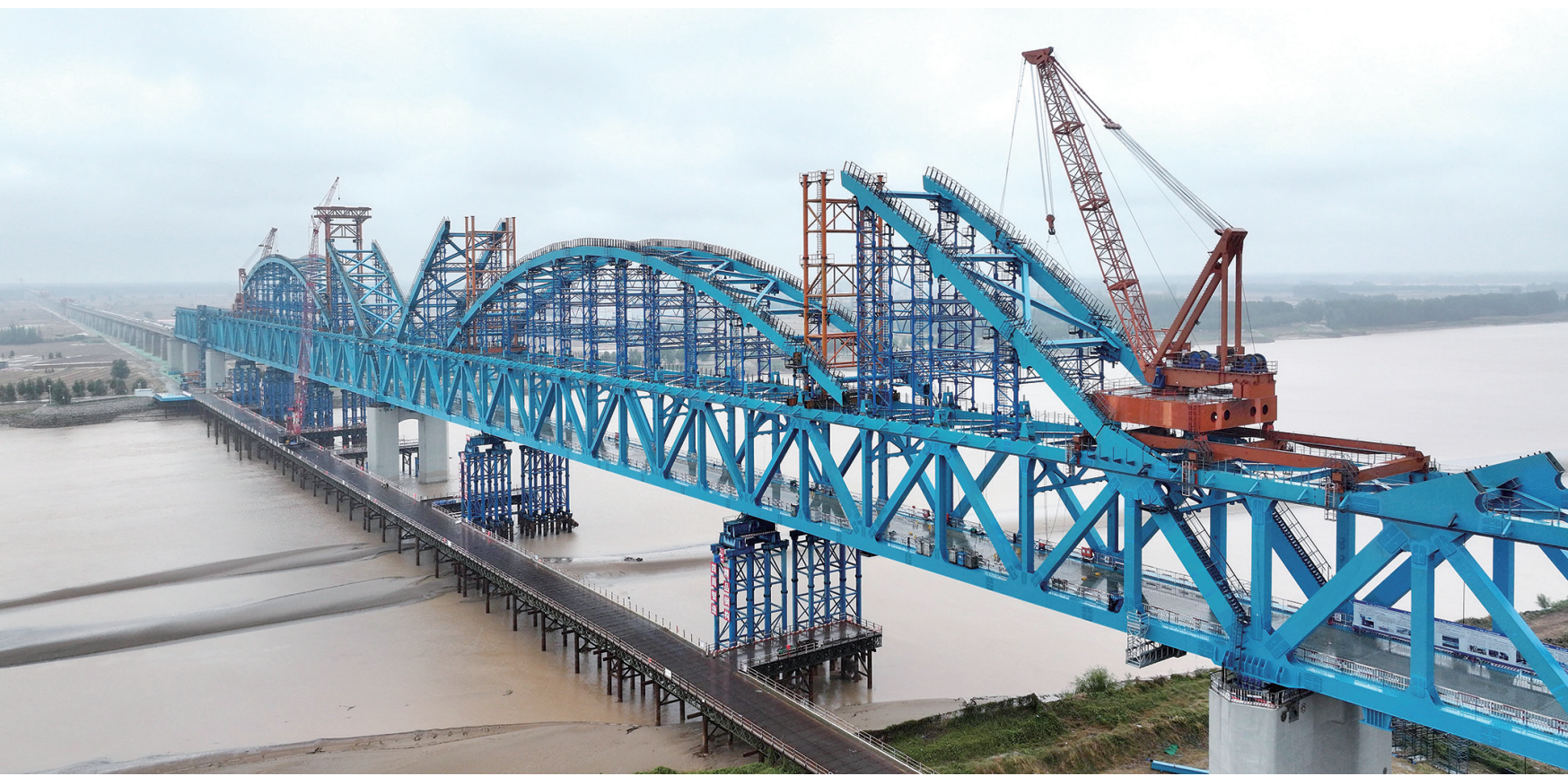
首个拱肋合龙10月18日拍摄的雄商高铁黄河特大桥主桥施工现场（无人照照片）。当天，由中铁四局集团承建的雄（安）商（丘）高铁跨黄河特大桥首个拱肋顺利合龙。雄商高铁黄河特大桥主桥在河南省台前县和山东省梁山县间跨越黄河，主桥总长1600米。雄商高铁是国家“八纵八横”高铁网的重要组成部分，北起河北雄安新区、南至河南商丘站，线路全长约552公里，设计时速350公里。
