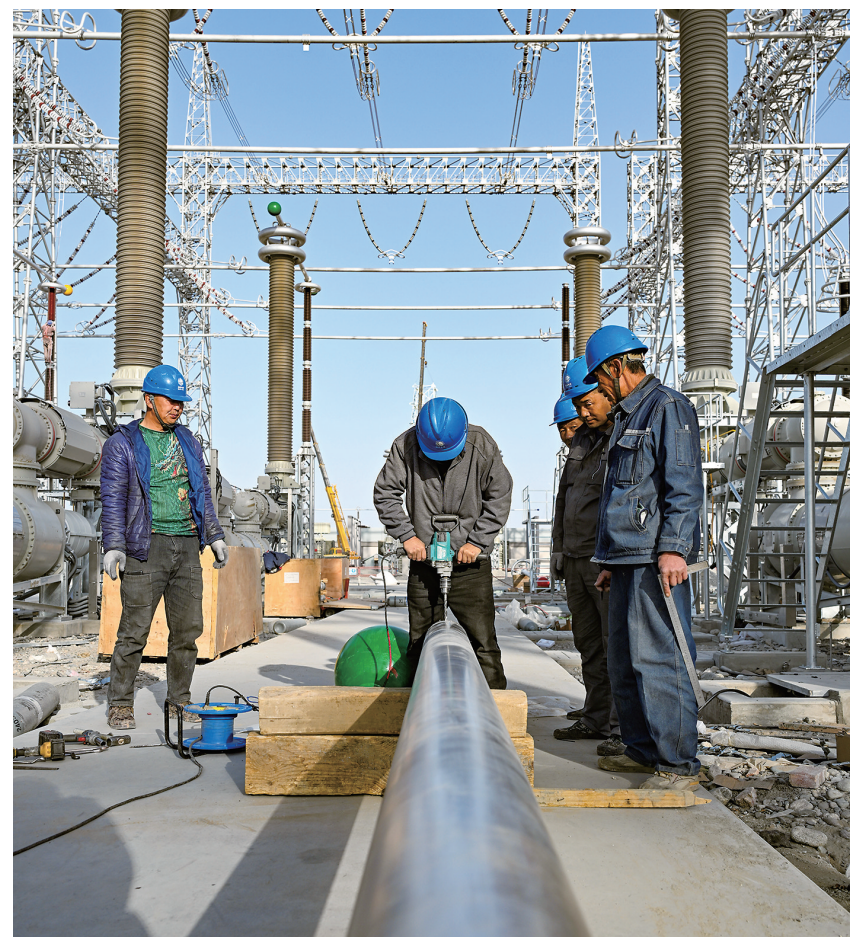
工人在新疆民丰750千伏变电站施工现场作业(11月10日摄)。750千伏和同一民丰—且末—若羌输变电工程是新疆环塔里木盆地750千伏输变电工程中的最后一役。眼下，电力工人奋战在工程一线，有序进行地面和高空作业。据国家电网新疆电力有限公司介绍，截至目前，工程施工总进度已过半。新华社记者 陈翔摄
