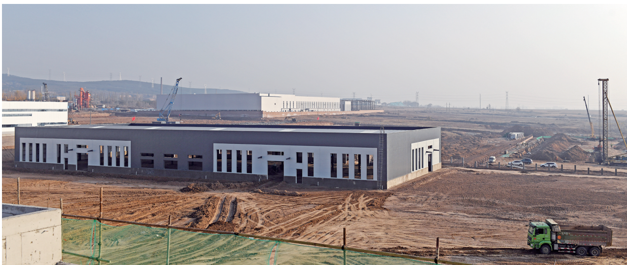
图为新荣经开区南京电气电力工程有限公司新能源装配式储能设备项目建设工地施工正酣。 本报记者 于宏摆
