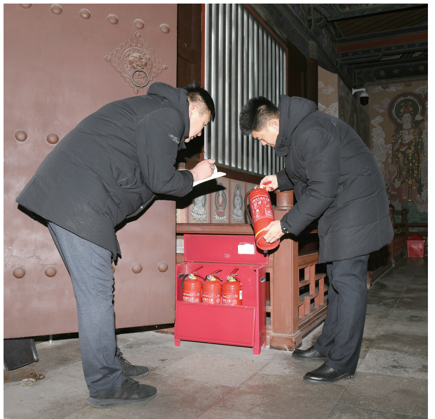
12月3日,华严寺景区工作人员检查消防应急设备。为强化冬季景区景点火灾风险防控和消防隐患排查,确保游客和文物安全,助力我市冬季旅游淡季不淡,连日来,我市各景区景点开展全方位安全隐患排查整治行动,重点对用电设施、消防控制室、微型消防站等进行检查,及时消除风险隐患,严防火灾事故发生。 本报记者 戎禹仁摄
