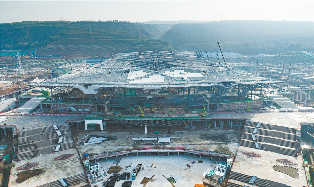
10月27日拍摄的特大型铁路综合交通枢纽西安东站建设现场(无人机照片)。 10月27日,西安东站最后一块总重达4800吨的屋盖钢结构桁架顺利提升至33米高空指定位置,标志着西安东站站房主体结构顺利完工。西安东站是集高铁、普铁、地铁、公交于一体的综合交通枢纽,建成投用后车站旅客年发送量预计可达3650万人次。 新华社发(刘翔摄)
