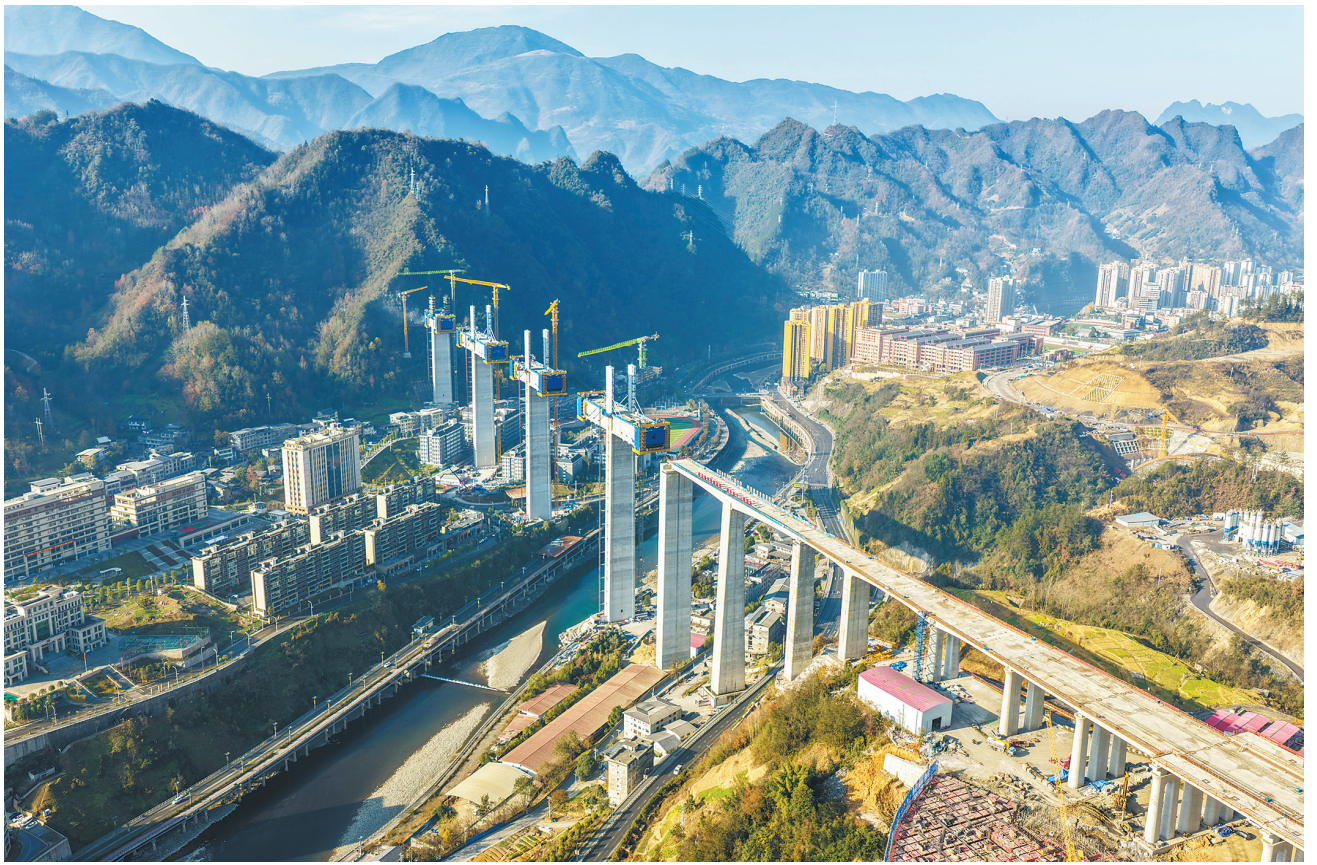
这是12月7日拍摄的西渝高铁任河特大桥建设现场（无人机照片）。12月7日，由中铁十二局承建的西渝高铁城口任河特大桥塔柱施工任务全部完成，全桥施工进度完成近七成，为西渝高铁全线按期贯通奠定了坚实基础。
