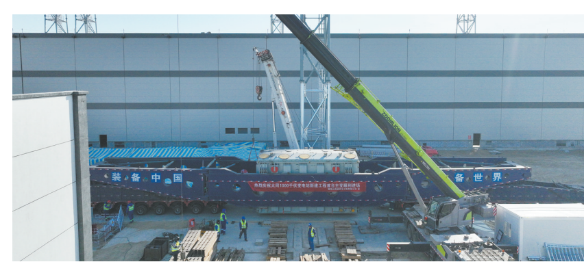
图为大同一怀来一天津南1000千伏特高压交流工程首台主变压器顺利运抵大同。 张彩峰摄
