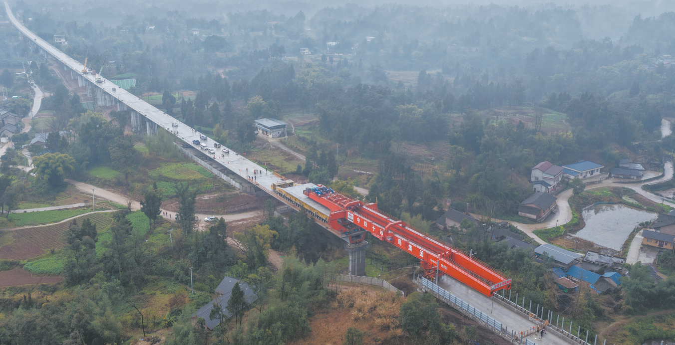
成渝中线高铁重庆大足段架梁完成 这是二月九日拍摄的成渝中线高铁重庆大足段第四百一十九榀箱梁架梁现场（无人照照片）。二月九日，随着最后一榀箱梁平稳就位，由中铁十四局承建的成渝中线高铁重庆大足段架梁任务收官，为后续无砟轨道铺设、铺轨施工创造条件。 成渝中线高铁是我国八纵八横高铁网沿江通道的重要组成部分，正线全长二百九十二公里，设计时速三百五十公里。 新华社记者 陈诚摄
