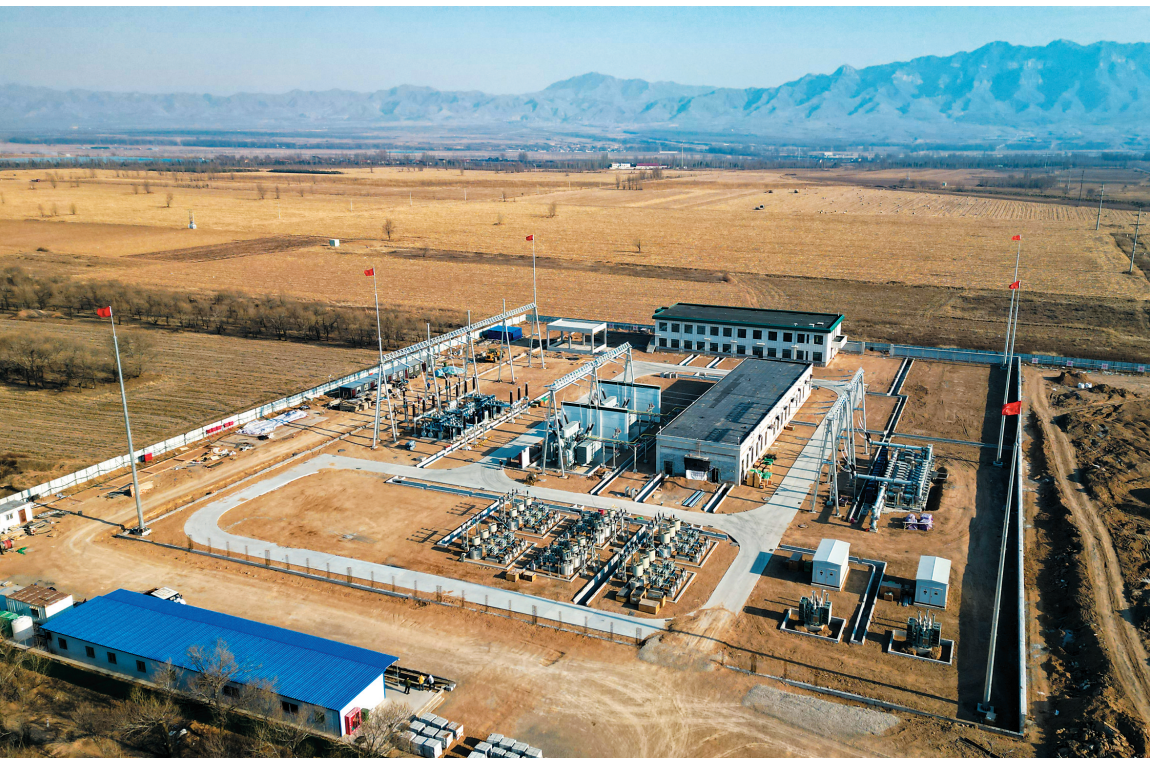
图为大同经开区零碳园区配套220千伏变电站。
