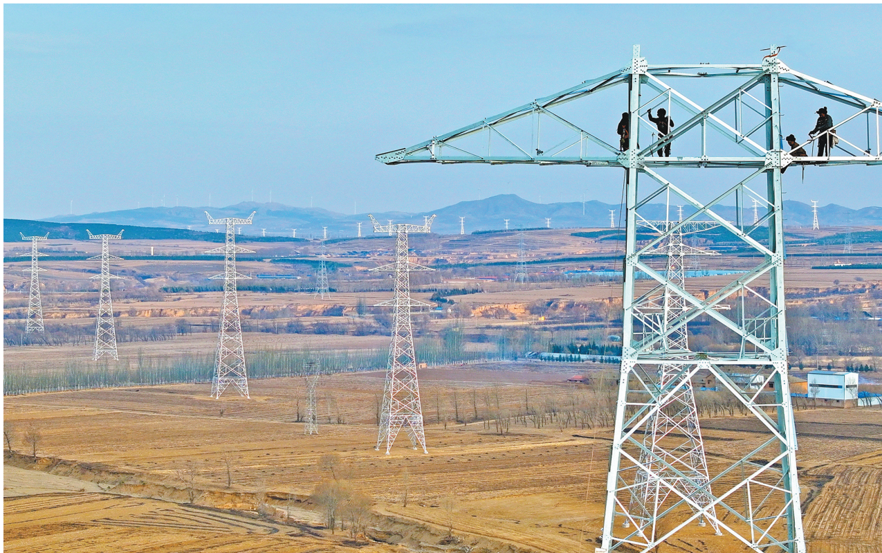
3月24日，大同东500千伏输电工程正紧张推进，该工程是大同—怀来—天津南特高压交流工程配套工程。工程建成后，将实现特高压站与区域主力变电站高效互联，大幅提升晋北新能源电力汇集、送出与消纳能力，为京津冀电力供应提供保障，助力山西能源基地转型升级和国家“双碳”目标落地。 本报记者 张占兵摄
