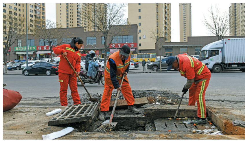
日前,平城区环卫处清洁一公司开展春季平面环境卫生清洗提升行动,对辖区内雨水篦子、污水管网的落叶淤泥进行清掏,赶在汛期到来前疏通管网,确保降雨来临时排水设施能高效收水、顺畅排水。图为该公司环卫工人对北苑路清理污水管网内淤泥。
