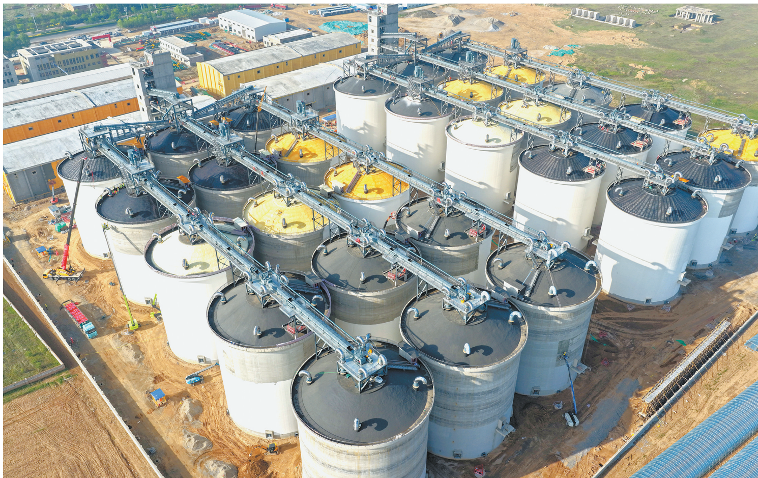
中储粮大同经开区仓储基地项目是我市重要粮食仓储基础设施工程，占地9.12公顷，总投资约5.25亿元，主要建设浅圆仓、平房仓及配套基础设施。当前，项目进入收尾攻坚阶段，正有序推进屋面防水保温、外墙保温及水电安装施工。项目建成后，将有效提升区域粮食仓储能力与应急保障水平，筑牢粮食安全防线。图为5月27日该项目施工现场。本报记者 张占兵摄
