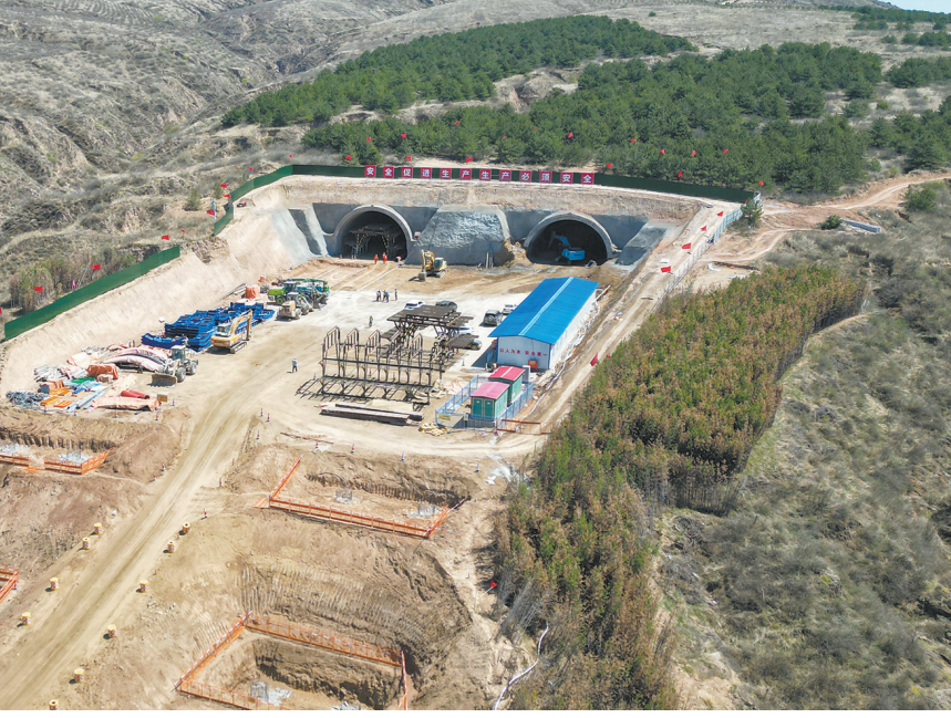
连日来，国道109线、208线大同市过境公路改线工程各施工单位抢抓工期，同步推进隧道掘进、桥梁浇筑、路基施工，项目建设驶入快车道。据了解，该项目总投资80多亿元，建成后将成为城市外圈货运大通道，在完善区域路网、缓解城区交通压力的同时，进一步拓展周边城市发展空间，为蒙晋冀（乌大张）长城金三角合作区建设注入交通动能，助力区域经济协同发展。图为5月28日，采凉山隧道口施工现场一派忙碌景象。本报记者 戎禹仁摄
