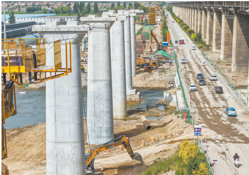
国电电力大同湖东发电有限公司运煤铁路专用线是配套电厂燃料保供的重点基建项目，建成后打通煤炭铁路直达进厂通道，大幅降低低运成本、提升输煤效率，对保障机组稳定运行、完善区域能源储运布局意义重大。
