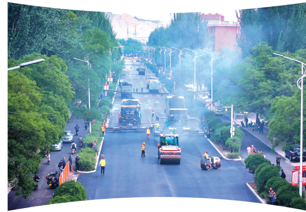
云冈区平泉街改造工程主线摊铺现场，工人们配合机械设备有条不紊推进路面摊铺、压实等工序。
