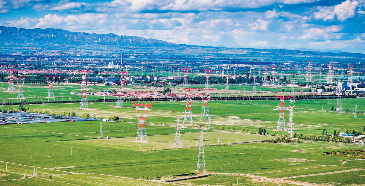
图为大同－怀来－天津南特高压交流工程山西侧配套电源送出工程。
