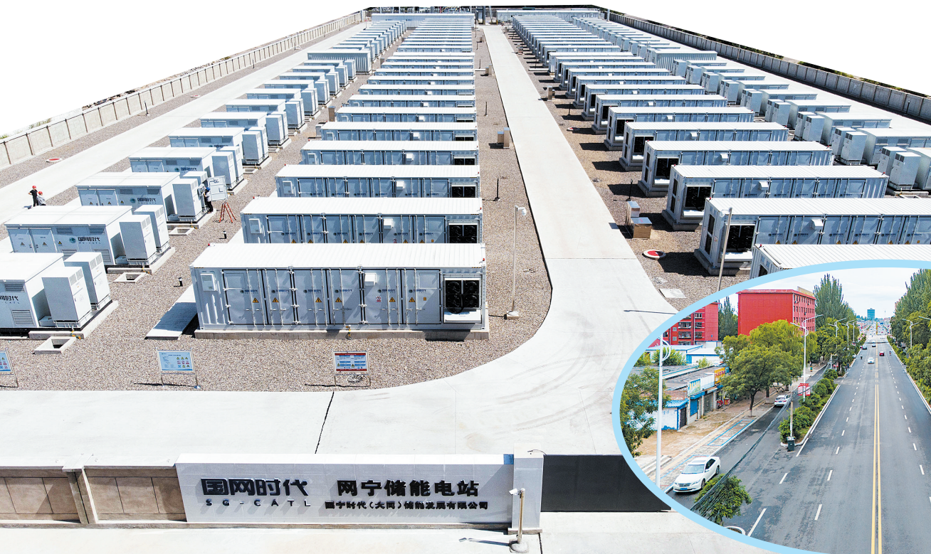
国网时代华电15万千瓦共享储能电站。
