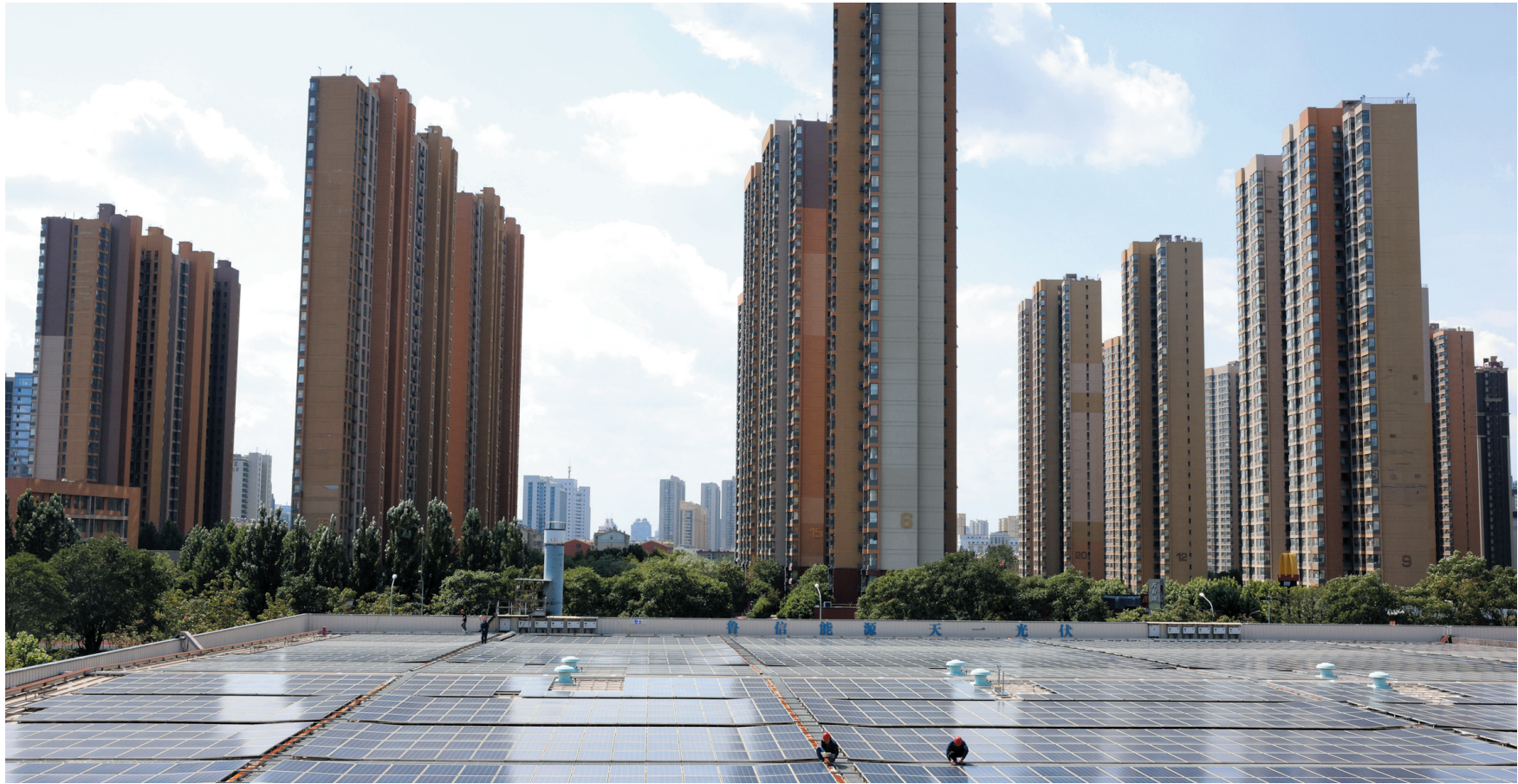
9月1日，工作人员在位于济南的鲁信天一厂区对屋顶1.598MWp分布式光伏电站进行运维检修。该项目由鲁信能源公司投资，鲁信能源公司控股单位山东泓奥电力负责建设、运维，充分利用厂房闲置资源，实现清洁能源开发，助力企业绿色低碳转型。 近年来，山东省持续优化金融服务供给，不断拓展转型金融应用场景，以金融服务赋能实体经济提质增效，推动传统产业实施绿色低碳迭代升级，统筹推进制造业高端化、智能化、绿色化协同发展。
